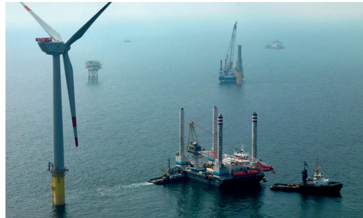
Installationsplattform für Windenergieanlagen in der Nordsee
